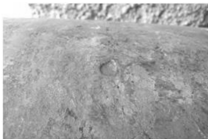
Důlkový defekt korozního typu
