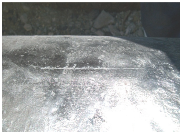
Obr. 13 – Detail zjištěného defektu
