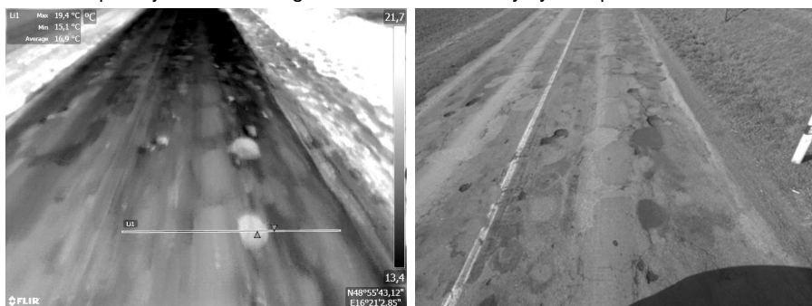
Obr. 10 Lokalizace vysprávek pomocí termokamery
