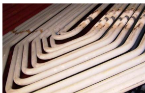
Obr. 14 Vnitřní kotlové trubky
