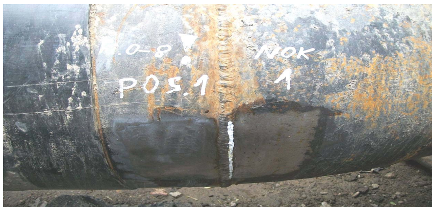
Obr. 4. Porušené svary na odkrytém potrubí v místě anomálie na magnetogramu.
