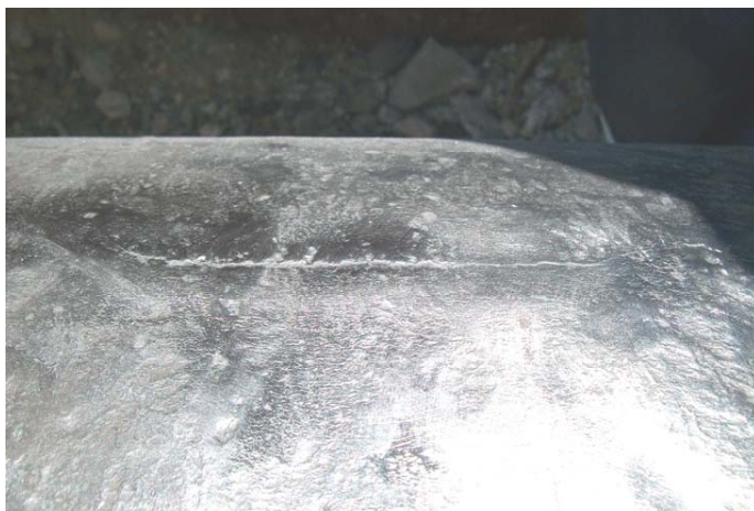
Obr. 7. Fotografie defektu (trhlina) na odkrytém a očištěném potrubí.
